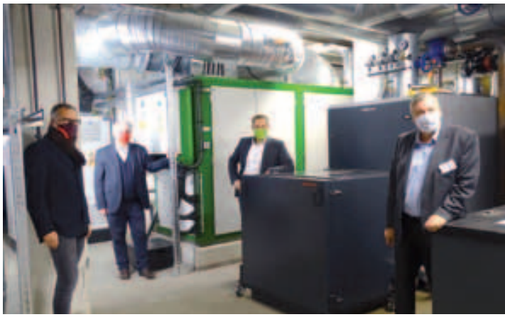
In 2020 wurde der gesamte Bereich Steinberg II an das Wärmenetz angeschlossen. Die Inbetriebnahme des Blockheizkraftwerkes erfolgte im September und beliefert Strom und Wärme für das Netzgebiet. Fotos: Rundschau-Archiv
