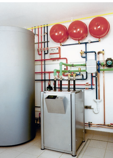
Wärmepumpe mit Speicher
